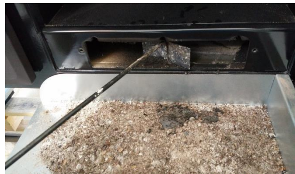
Figure n°14 - Accès pour le nettoyage de la sortie de fumée
